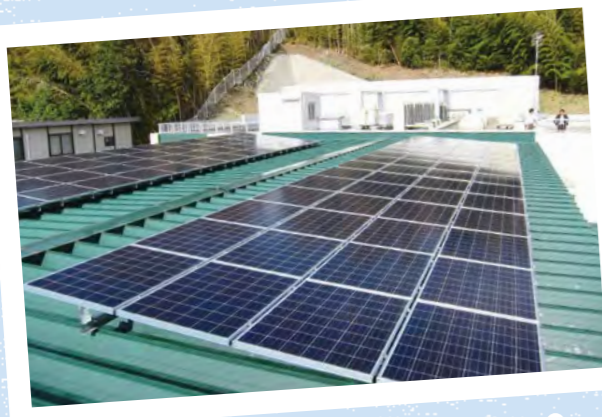
宮前センター太陽光発電設備
